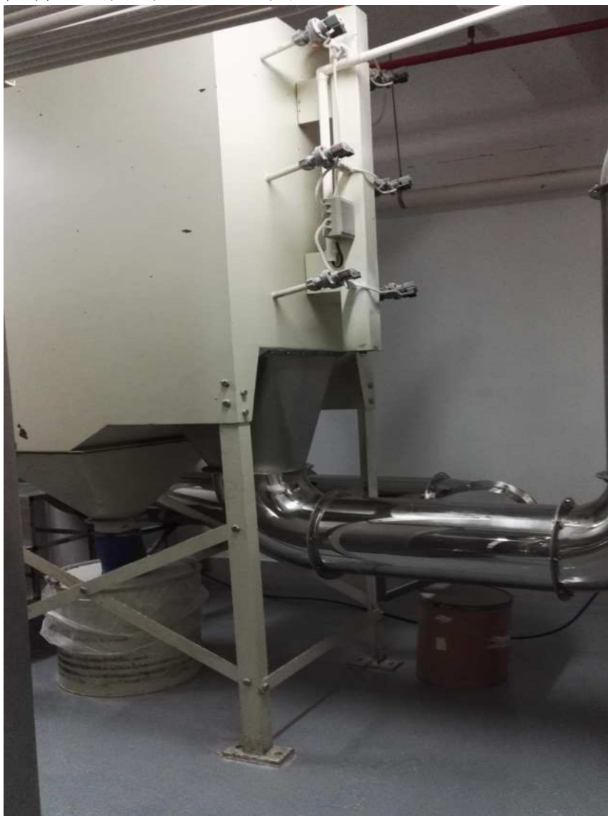
附件 5：废气处理工艺设施
